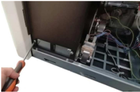
Fig. 103 - Limpieza ventilador ambiente
