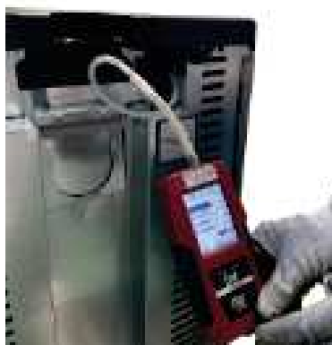
Fig. 111 - Conexión del presostato digital (Atena - Duke)
