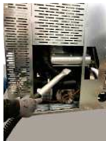
Fig. 133 - Limpieza ventilador ambiente
