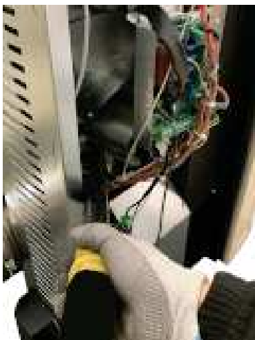
Fig. 132 - Limpieza ventilador ambiente
