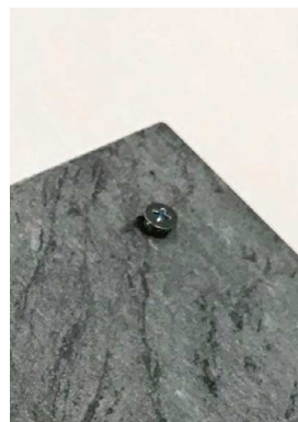
Fig. 62 - El tornillo debe sobresalir
