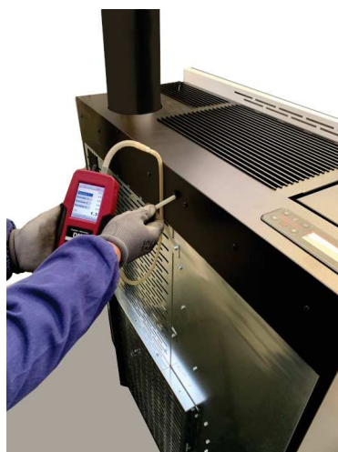
Fig. 112 - Conexión del presostato digital (Mithos)
