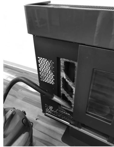
Fig. 38 - Limpieza camara de humos
