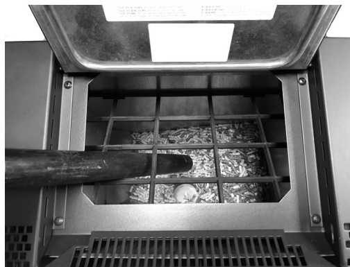
Fig. 34 - Limpieza depósito y coclea
