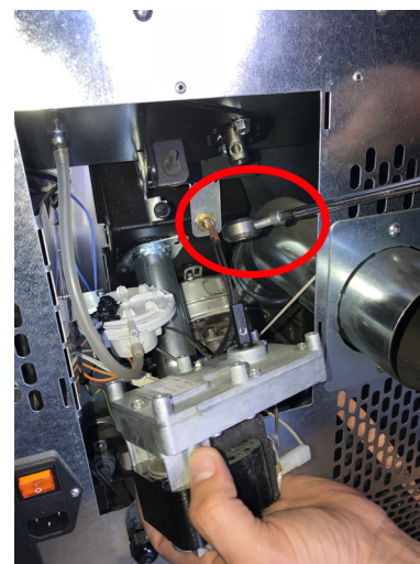
Fig. 92 - Extracción del motorreductor
