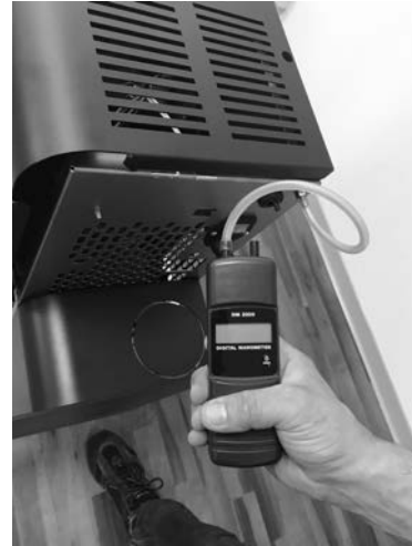
Fig. 48 - Conexión del presostato digital
