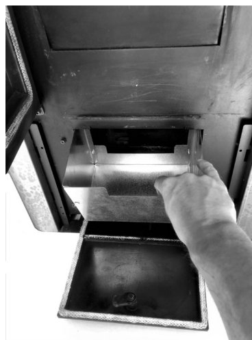
Fig. 59 - Retire la tapa de inspección
