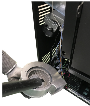
Fig. 94 - Limpieza del ventilador ambiente
