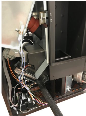
Fig. 92 - Limpieza ventilador ambiente
