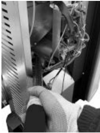
Fig. 127 - Limpieza ventilador ambiente
