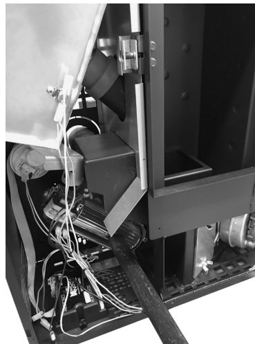
Fig. 65 - Limpieza ventilador ambiente
