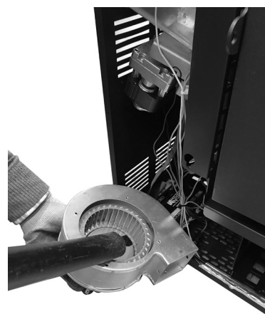
Fig. 67 - Limpieza del ventilador ambiente
