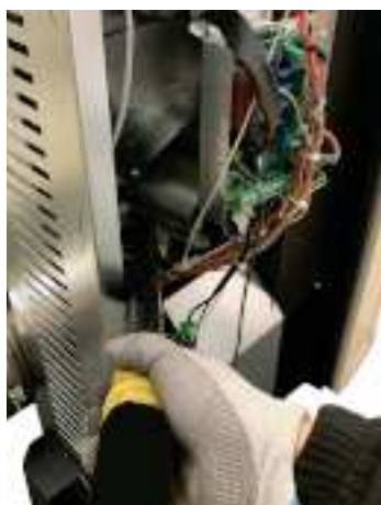
Fig. 83 - Limpieza ventilador ambiente
