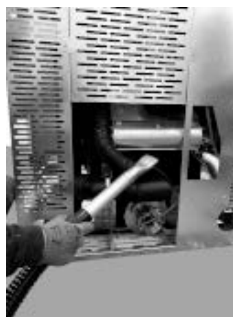
Fig. 89 - Limpieza ventilador ambiente
