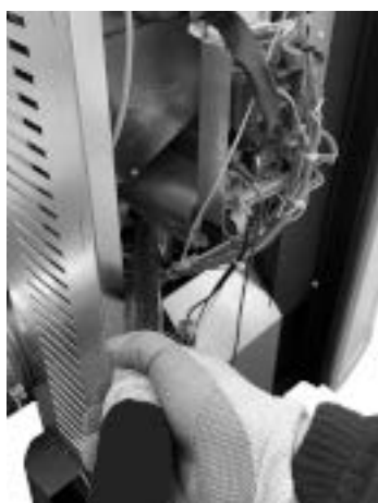
Fig. 88 - Limpieza ventilador ambiente
