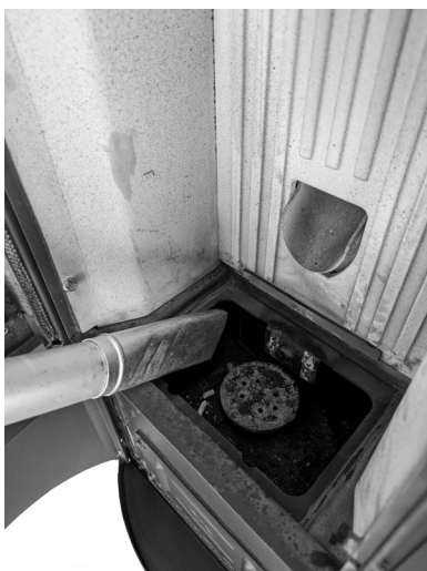
Fig. 38 - Limpieza alojamiento brasero
