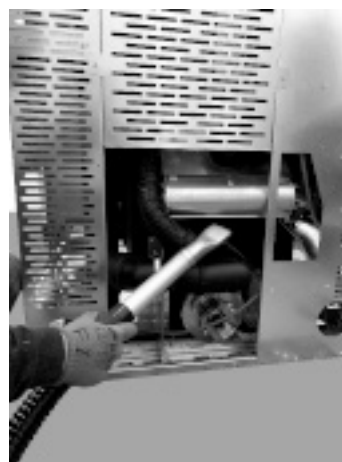
Fig. 61 - Limpieza ventilador ambiente
