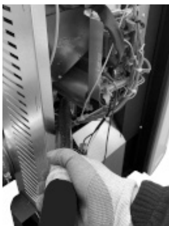
Fig. 60 - Limpieza ventilador ambiente
