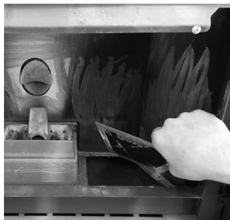
Fig. 27 - Retire la tapa de inspección
