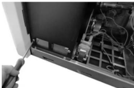
Fig. 82 - Limpieza ventilador ambiente (Atena 3 Plus 12/14 - Duke 12/14 At - Saba 12/14)
