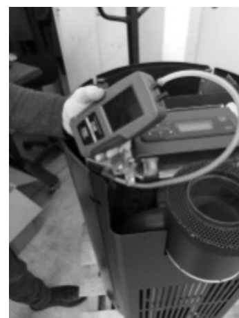
Fig. 64 - Conexión del presostato digital
