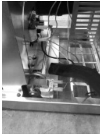
Fig. 75 - Limpieza ventilador ambiente
